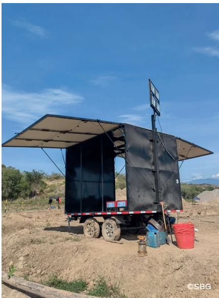
► Panel solar móvil instalado en una operación minera para alimentar la iluminación de la operación durante la noche.
